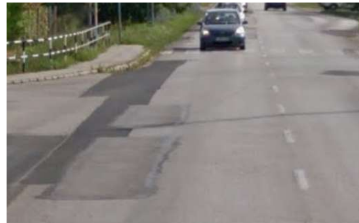
Az úthelyreállítás hibái, eltérő színű burkolatok
